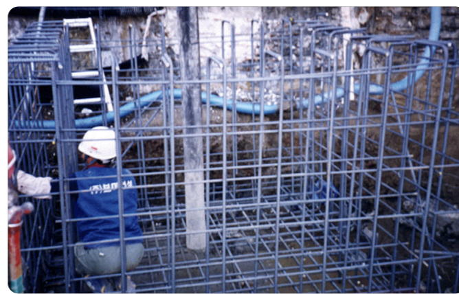
鉄筋の過大な配筋のため作業難易度上昇
