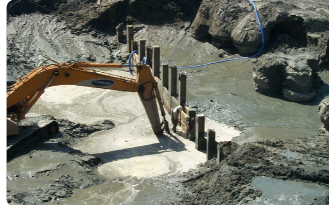
地下水の流入のためコンクリート品質低下
